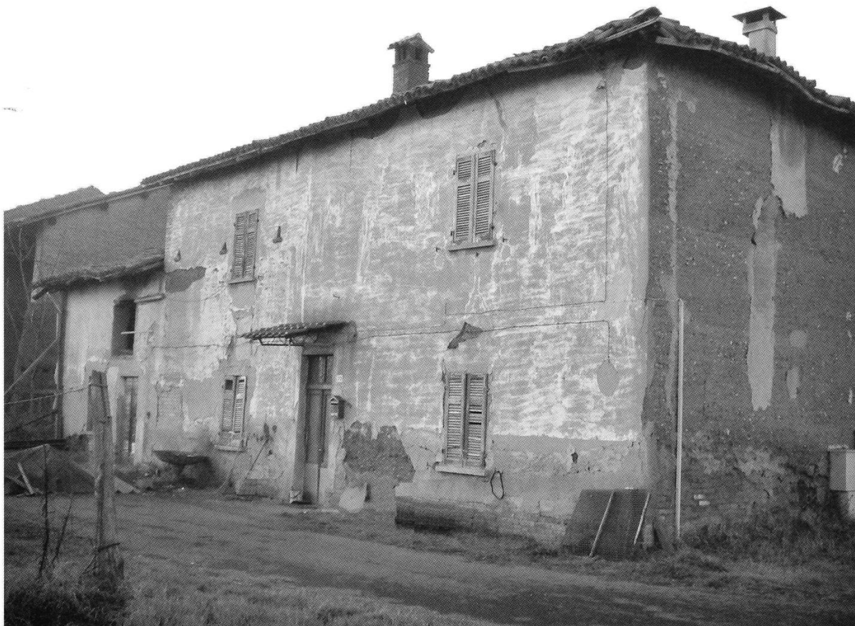
Cascina Ponzanina di strada Roveri. La facciata è intonacata. Sul lato destro è possibile notare la mancanza di pilastri angolari.
