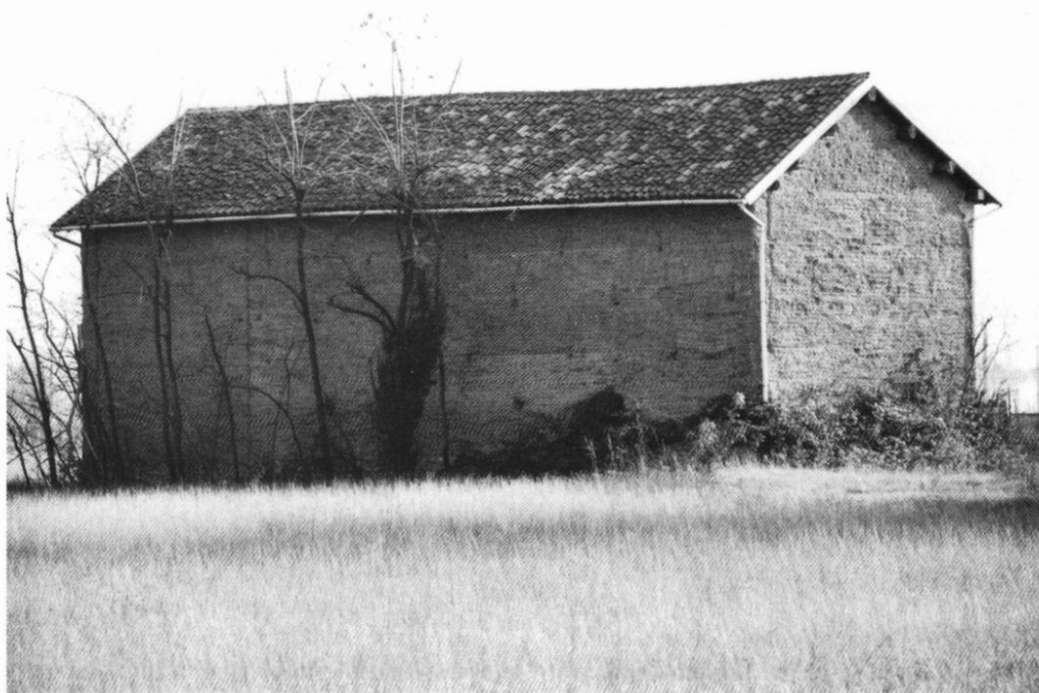
Un tipica costruzione rustica - "trunera" - priva di intonaco, conformemente alla tradizionale tecnica di costruzione del manufatto. Nel segmento frontale si percepiscono le tracce di intersezione dei blocchi modulari in terra battuta predisposti nelle casseforme.
